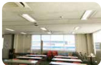
蛍光灯からLED照明に入れ替えた本社屋内。
